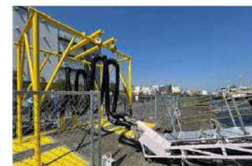
給電設備(川崎港)
